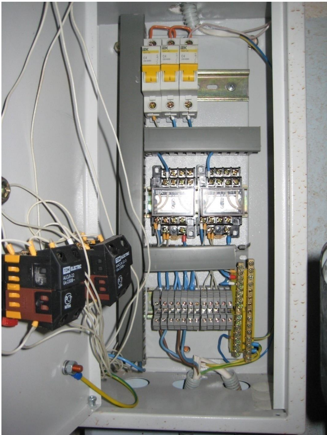
Рисунок 1.10 – Щит управления насосами
