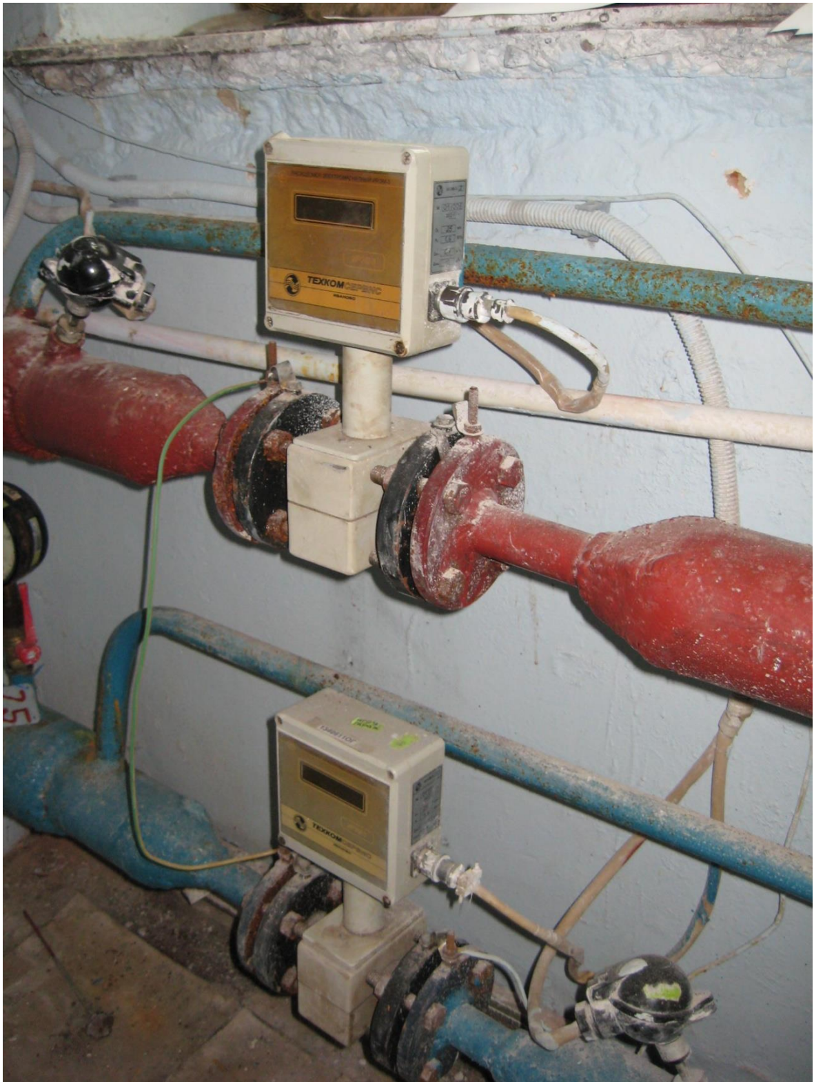
Рисунок 1.11 – Преобразователь расхода электромагнитный системы отопления
