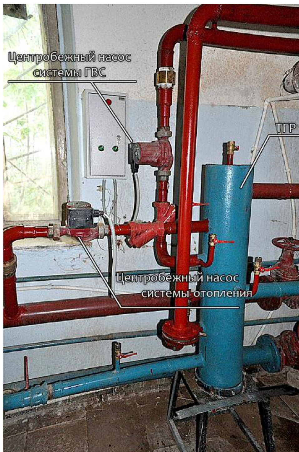
Рисунок 1.1 - Внешний вид теплового пункта абонента «Гараж»
