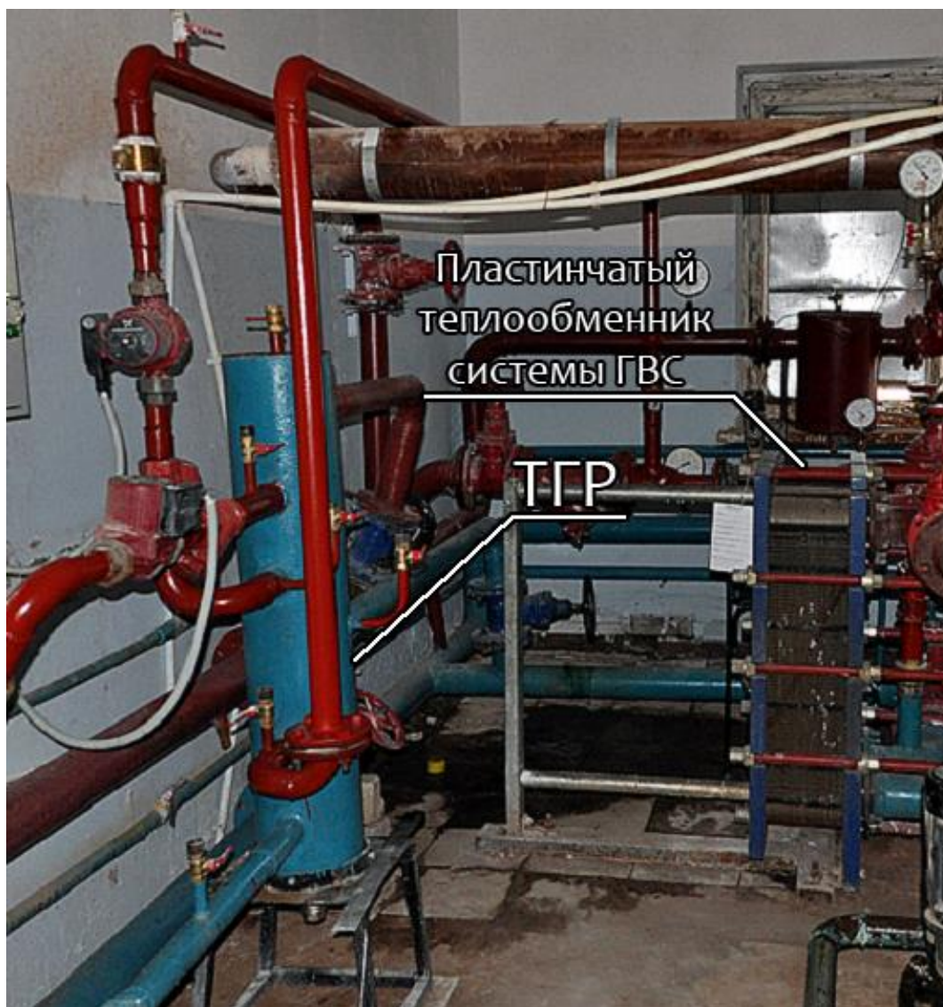
Рисунок 1.2 - Внешний вид теплового пункта абонента «Гараж»
