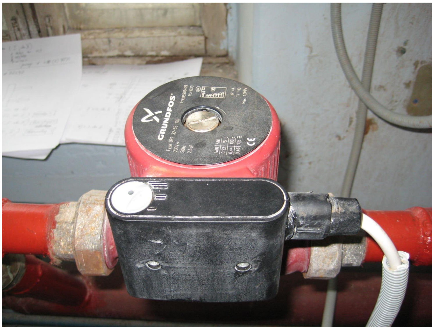
Рисунок 1.7 - Насос контура отопления UPS-32-55
