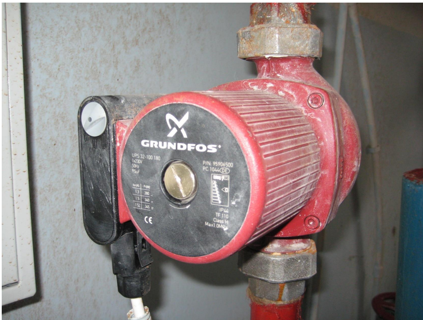
Рисунок 1.8 - Насос контура горячего водоснабжения UPS-32-100
