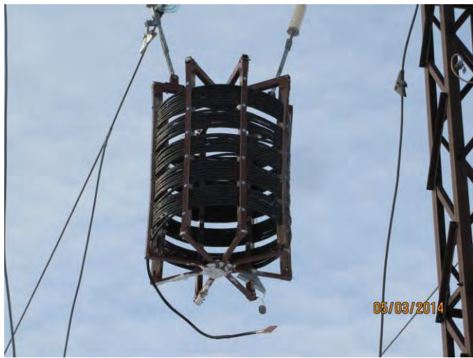
Рис. 4. Примеры установки ЧЗУ на подстанции с напряжением 110 кВ Ноябрьских электрических сетей ОАО «Тюменьэнерго»
