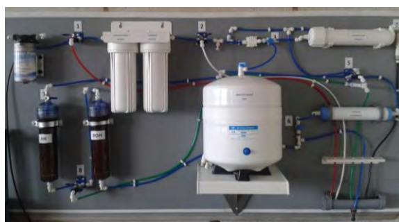
Рис. 1. ЛАБОРАТОРНЫЙ СТЭНД «УСТАНОВКА ОБРАТНОГО ОСМОСА И ХИМИЧЕСКОГО ОБЕССОЛИВАНИЯ»
