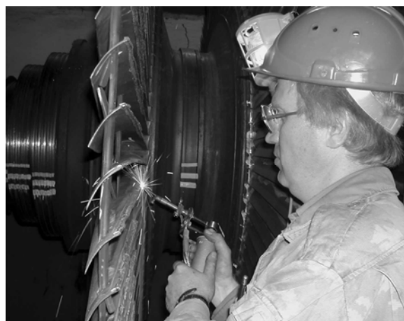
Рис. 6. Нанесение металллизатором защитных покрытий на лопатки 30-й ступени при ремонте турбины ПТ-80-130/30 ЛМЗ АО «Кишиневская ТЭЦ-2» (ст. №1) при расположении ротора на козлах ремонтной площадки
